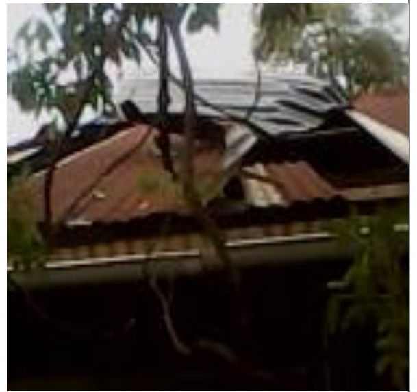
le Centre de Sante BUHAMBA dont la toiture est démolie
